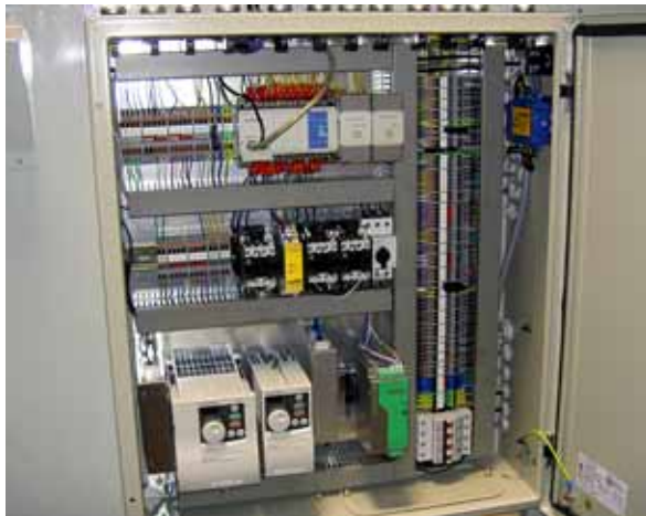
WSM 101 / WSM 102 Schaltschrank
